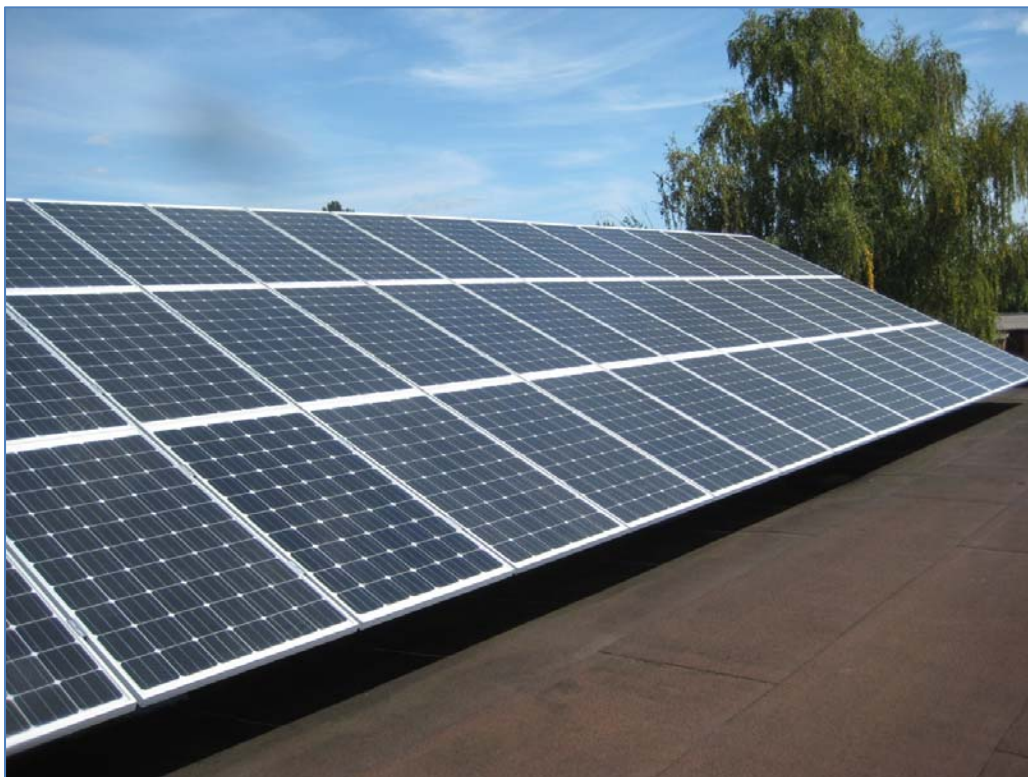
Figure 2: Le système photovoltaïque de l'École élémentaire Jeanne-Lajoie
